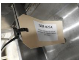
Referencia: GBF-026 VIBRADOR DOSIFICADOR Año: . Marca: .
