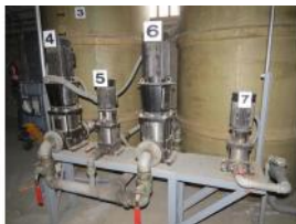
Referencia: SER-083 CONJUNTO DE BOMBAS Año: . Marca: .
