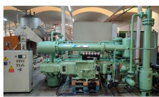
Referencia: FTR-015 COMPRESOR DE AIRE Año: 1990 Marca: ABC
