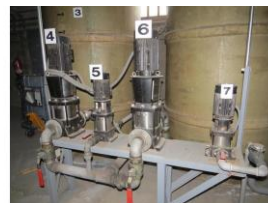
Referencia: SER-083 CONJUNTO DE BOMBAS Año: . Marca: .
