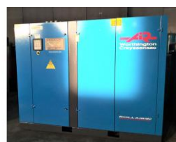
Referencia: AGC-018 COMPRESOR DE TORNILLO Año: 2002 Marca: WORTHINGTON CREYSSENSAC
