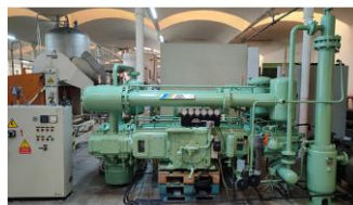
Referencia: FTR-015 COMPRESOR DE AIRE Año: 1990 Marca: ABC
