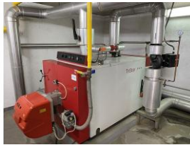
Referencia: LFR-113 CALDERA DE AGUA CALIENTE Año: . Marca: ROCA
