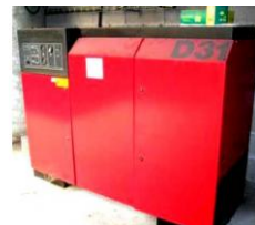
Referencia: M-929 COMPRESOR Año: 1992 Marca: ECO AIR
