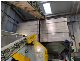
Referencia: MZA-008 TOLVA DE ALMACENAMIENTO Año: 2018 Marca: .
