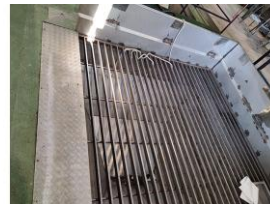
Referencia: MZA-002 TOLVA DE RECEPCION Año: 2018 Marca: .
