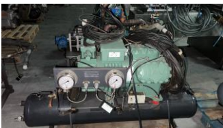
Referencia: MOR-197 EQUIPO DE FRIO Año: 2009 Marca: TORRECILLA COMP.FRIGORIFICOS
