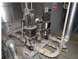
Referencia: SER-084 CONJUNTO DE BOMBAS Año: . Marca: .
