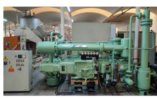
Referencia: FTR-015 COMPRESOR DE AIRE Año: 1990 Marca: ABC
