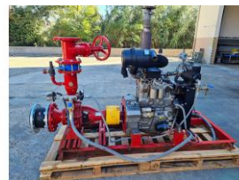
Referencia: TES-001 ANTI INCEDIOS Año: 2006 Marca: MWM Motores Diesel LTDA
