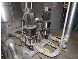
Referencia: SER-084 CONJUNTO DE BOMBAS Año: . Marca: .
