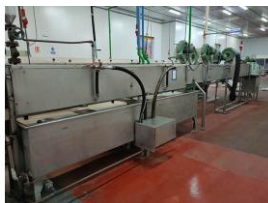
Referencia: TVE-038 TUNEL DE LAVADO Y SECADO Año: . Marca: .
