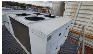
Referencia: AGC-009 UNIDAD DE ENFRIAMIENTO Año: 2006 Marca: CLIMAVENETTA
