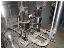
Referencia: SER-084 CONJUNTO DE BOMBAS Año: . Marca: .
