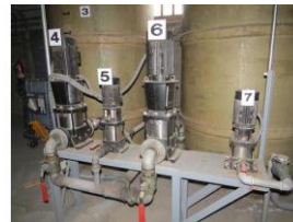
Referencia: SER-083 CONJUNTO DE BOMBAS Año: . Marca: .
