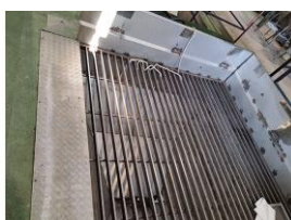
Referencia: MZA-002 TOLVA DE RECEPCION Año: 2018 Marca: .
