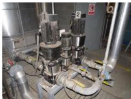
Referencia: SER-084 CONJUNTO DE BOMBAS Año: . Marca: .
