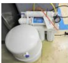
Referencia: AVI-004 OSMOSIS Año: . Marca: .
