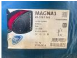
Referencia: LFR-098 BOMBA IMPULSORA Año: . Marca: GRUNDFOS
