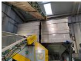
Referencia: MZA-008 TOLVA DE ALMACENAMIENTO Año: 2018 Marca: .
