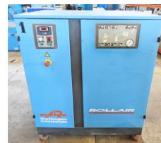
Referencia: PGI-002 COMPRESOR DE TORNILLO Año: 2000 Marca: WORTHINGTON CREYSSENSAC
