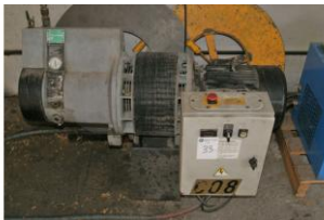
Referencia: JHA-031 COMPRESOR DE AIRE Año: . Marca: COMP AIR
