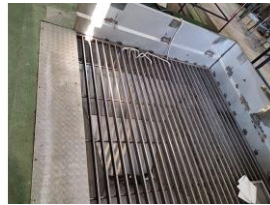
Referencia: MZA-002 TOLVA DE RECEPCION Año: 2018 Marca: .
