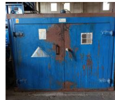
Referencia: NVT-091 CAMARA CALIENTE ELECTRICA Año: . Marca: ANINGAS
