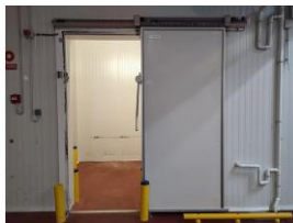
Referencia: FPN-078 PUERTA FRIGORIFICA CORREDERA Año: . Marca: INFRACA
