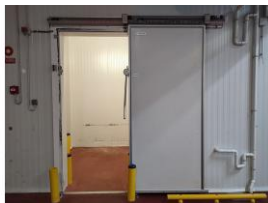
Referencia: FPN-078 PUERTA FRIGORIFICA CORREDERA Año: . Marca: INFRACA
