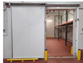
Referencia: FPN-076 PUERTA FRIGORIFICA CORREDERA Año: . Marca: INFRACA
