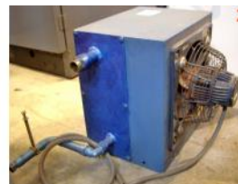
Referencia: BUS-006 REFRIGERADOR AIRE-AGUA Año: . Marca: AIRSEC
