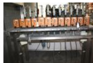
Referencia: BPS-066 GRUPO DE BOMBAS Año: . Marca: PROMINENT
