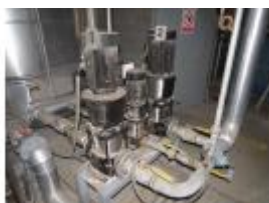
Referencia: SER-084 CONJUNTO DE BOMBAS Año: . Marca: .
