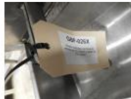
Referencia: GBF-026 VIBRADOR DOSIFICADOR Año: . Marca: .
