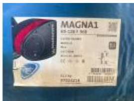
Referencia: LFR-098 BOMBA IMPULSORA Año: . Marca: GRUNDFOS
