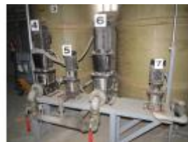
Referencia: SER-083 CONJUNTO DE BOMBAS Año: . Marca: .
