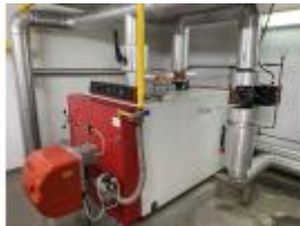
Referencia: LFR-113 CALDERA DE AGUA CALIENTE Año: . Marca: ROCA
